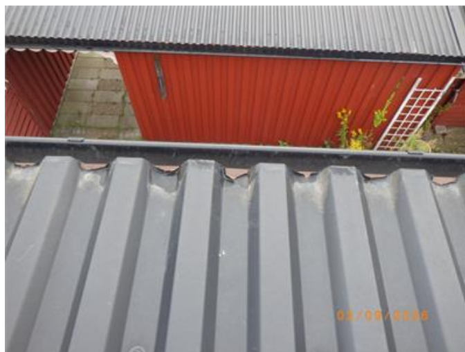
Färgsläpp samt rostangrepp noterades främst i nederdel av yttertakets plåttäckning.
