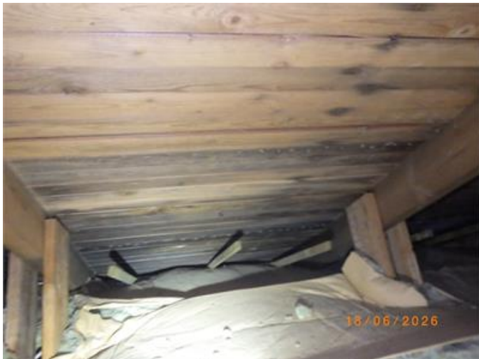
Mikrobiell påväxt på underlagstak inockvind.
