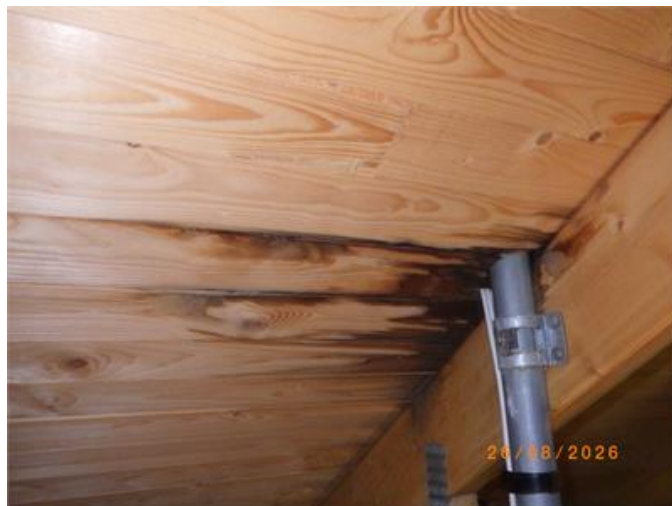
Missfärgning inockvind vid antenn genomföring.
