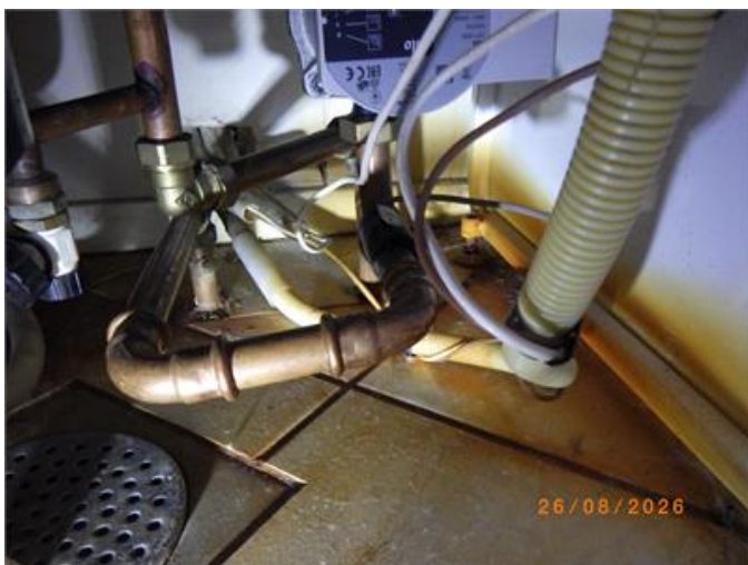
Missfärgningar noterades på nedre del av vägg/golv i närhet till frånluftsvärmepumpen.
