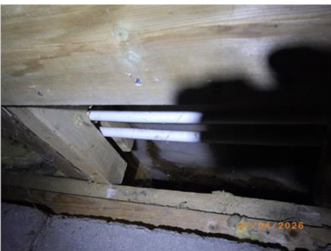
Va-installationer är blottade och utsatta för frysrisk (krypgrund 2).
