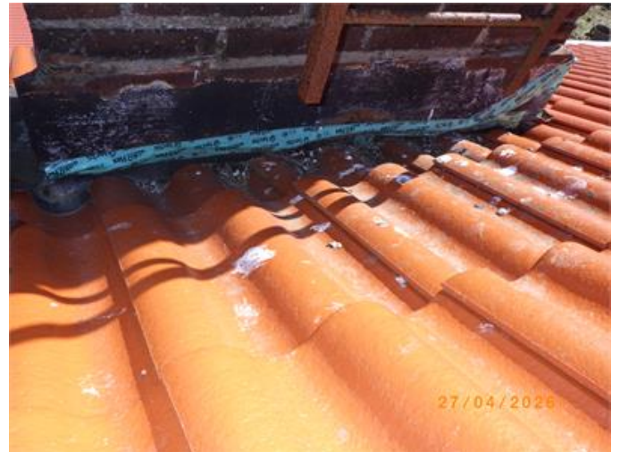
Plåtbeslag till skorstenar är av äldre standard, tätning beslagning på ovansida av den ena skorstenen är bristfälligt utfört.
